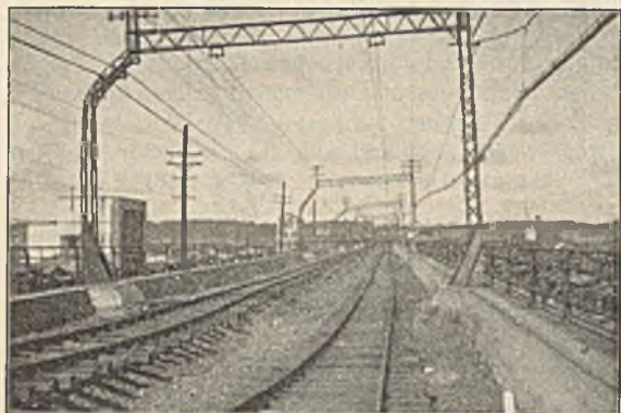
Abb. 25. Schnellbahn Yokohama—Sakuragicho. Auseinanderrütteln der den Bahnkörper begrenzenden Stützmauern und dadurch verursachte Verbiegung der Leitungsmaste.
