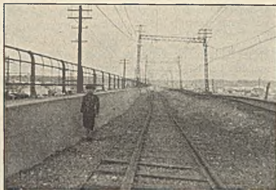
Abb. 26. Schnellbahn Yokohama—Sakuragicho. Sackung des Bahnkörpers infolge Auseinanderrüttelns der Stützmauern.
