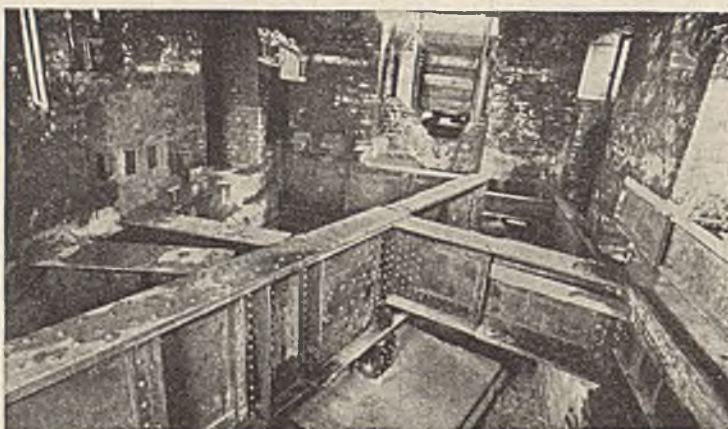
Abb. 2. Hauptträger—und vorläufig ummantelte Isolierstütze im Keller des Hauses Reichenberger Straße 13 u. 14.
