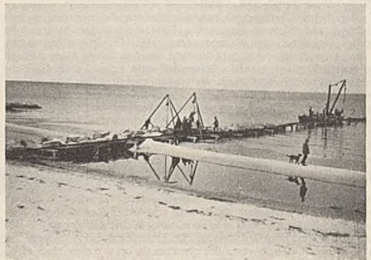
Abb. 35. Faschinenbuhnen auf Zingst. Herstellung des seeseitigen Teiles. Verbauen mittels Freiboaks, da Steinprahm nicht heranschwimmt.
