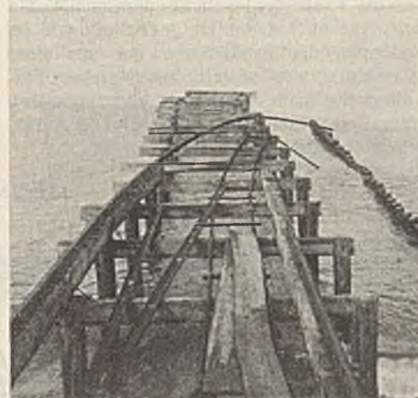
Abb. 52. Durch Seegang beschädigtes Rammgerüst bei Henkenhagen.
