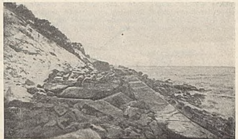
Abb. 64. Durch die Sturmflut 1913/14 zerstörtes Deckwerk am Streckelsberge.
