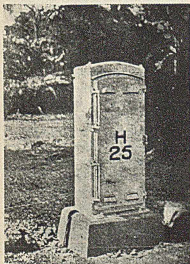
Ryc. 5. Szafka torowa zawierająca przekazniki i transformatoriki
