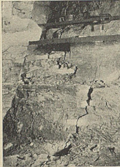
Abb. 15. Äußerer Riß im Übergangszwickel vom Dachraum aus gesehen.
