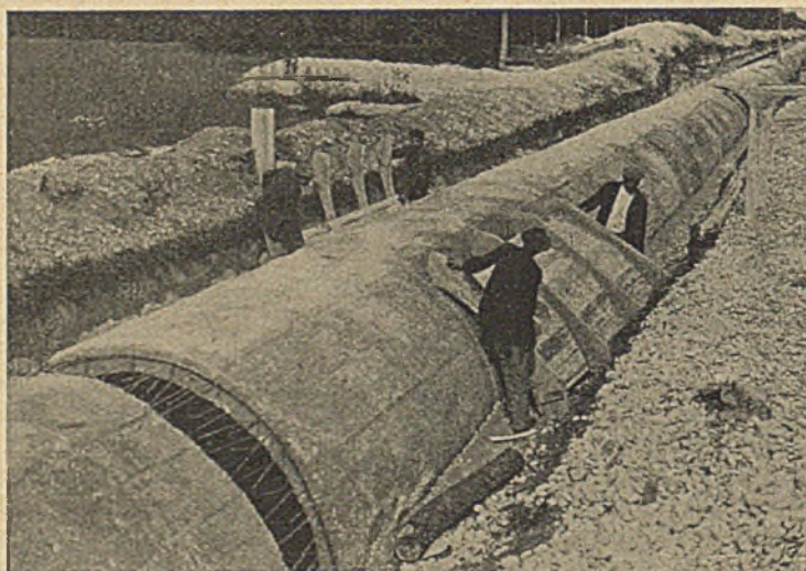
Abb. 6. Ausgeführte Teilstücke mit offenen Dehnfugen.
