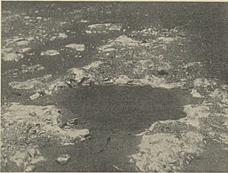
Abb. 3. Versinkungsstelle im Pfeilerfundament II (Draufsicht).
