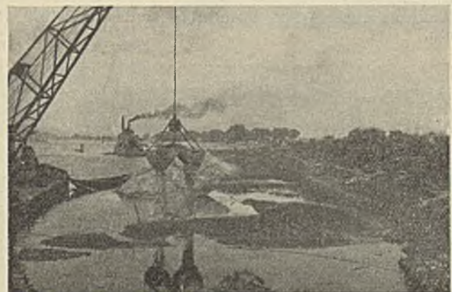
Abb. 27. Elbeausbau bei Hohndorf. Räumung eines stark verlandeten Bühnenfeldes vor der Streichlinie und Anschüttung des neuen Deckwerkes dahinter.
