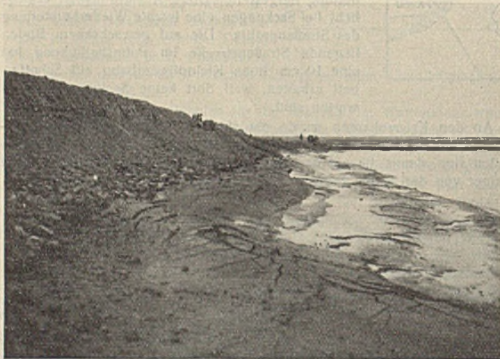
Abb. 9. Dammschüttung im Watt. Seitliches Emporquellen des weichen Untergrundes.
