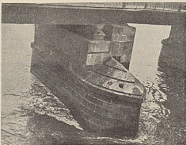
Abb. 10. Alte Brücke. Pfeiler 3, oberes Ende am 24. November 1930. (Wasserstand: Pegel Höxter + 5,87 m.)
