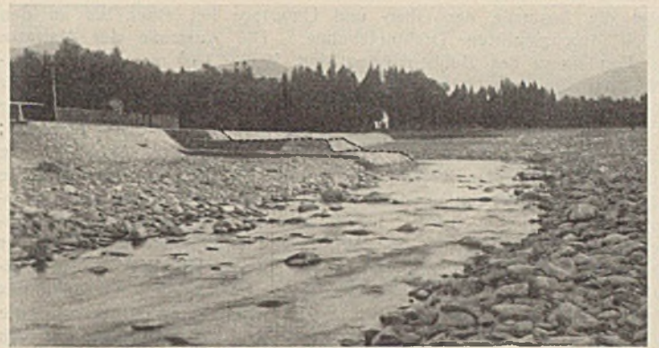
Abb. 25. Dieselben Bühnenbauten wie Abb. 24 nach Ablauf des Hochwassers. Wirkung der Drahtnetzmatratze.
