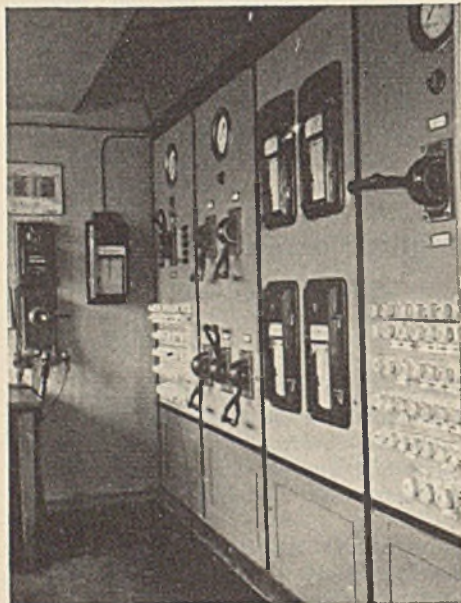
Abb. 15. Unterhaupt. Schalttafel im Aufenthaltsraum des Betriebsführers.
