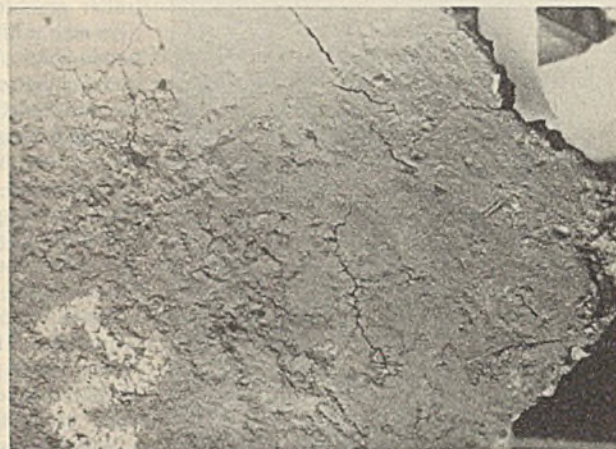
Abb. 5. Rissige Straßendecke, für Vialolbehandlung geeignet.
