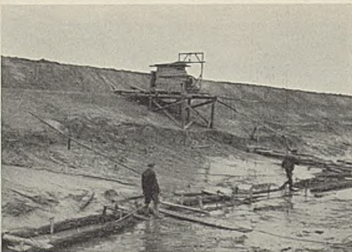
Abb. 7. Rutschungen der Böschung bei km 1,1. In der Mitte die Entwässerungspumpe.
