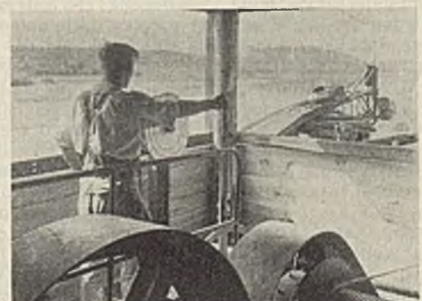
Abb. 5. Maschinenstand einer Schrapperanlage. Werkphoto: Bleichert.
