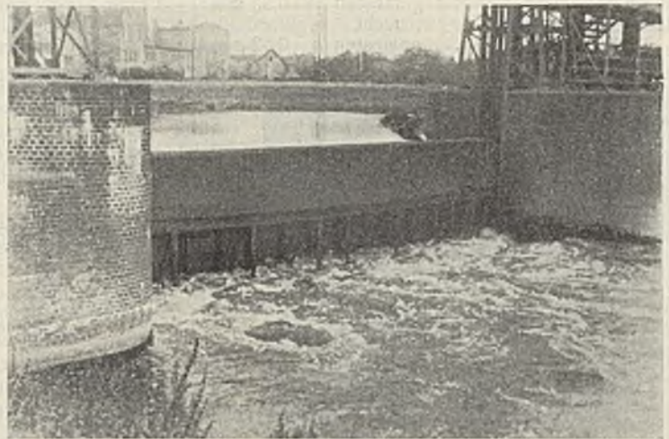
Abb. 11. Schütze G in gezogenem Zustande, vom Unterwasser aus gesehen.
