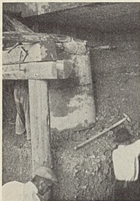
Abb. 13. Herabgesunkenes Ende des Unterzugbalkens mit dem unterstützenden behelfsmäßigen Betonbrunnen.
