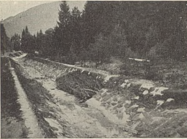
Abb. 17. Starke Uferanbrüche in einem gepflasterten Wasserlauf (Forsttechnische Abteilung für Wildbachverbauung, Sektion Kärnten).
