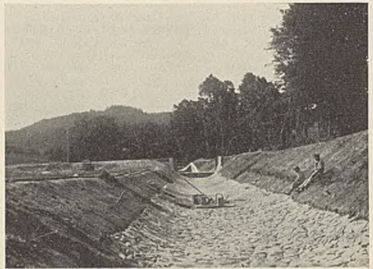
Abb. 14. Sohlenpflaster im Fenterbach (Kulturbauamt Weilheim).
