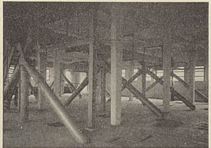
Abb. 7. Verteilungsleitungen im Dachgeschoß.
