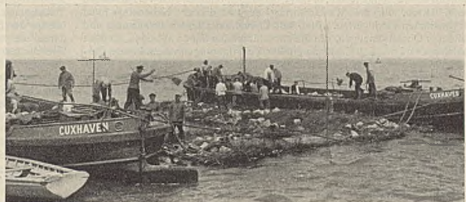
Abb. 17. Senkstück an der Senkstelle, festgehalten in seiner Lage durch sechs Tauen an ausgebrachten Ankern (nicht zu sehen), davon je zwei nach oberstrom und unterstrom, je einer nach dem Lande und dem Wasser zu. Das Beschweren des Stückes mit Schüttsteinen beginnt. Zunächst ist es noch an jeder der beiden Schuten mit Tauen aufgehängt.
