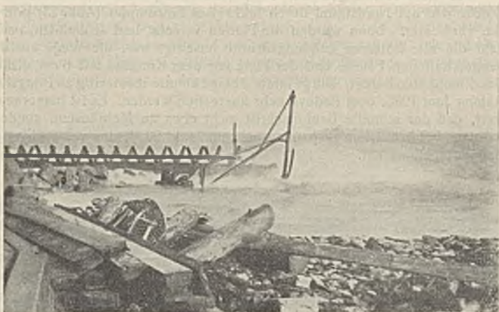
Abb. 20. Zerstörung des Rammgerüsts am 17. Februar 1935.
