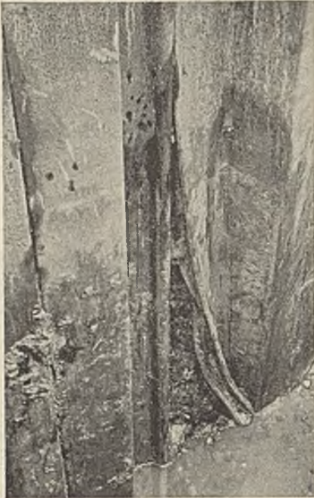
Abb. 22. Ausgewichene und abgerissene Bohle der Spundwand am Nordstrand. Blick gegen die ehemalige Rammrichtung.
