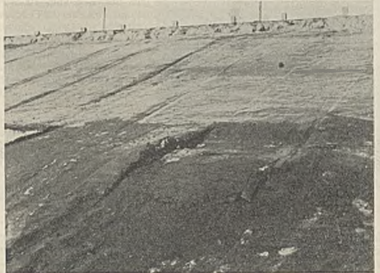
Abb. 11. Fehlstelle infolge Durchsackens der Walze bei nicht genügend standfähigem Untergrund.
