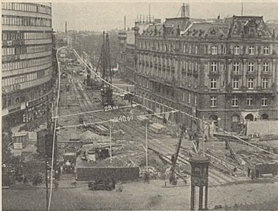
Abb. 1. Ansicht der Gesamtbaustelle bei Beginn der Rammarbeiten auf der Straße. Die Tunnelaußenkanten sind besonders angedeutet.
