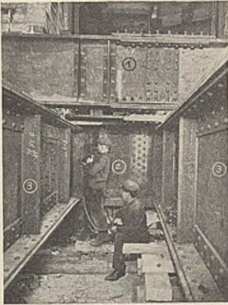
Abb. 9. Der Hauptabfangeträger (3) wird mit dem Unterzug (2) vernietet. Der Streichträger (1) hat an dieser Stelle einen biegefesten Fuß mit unbearbeiteten Schrauben erhalten.
