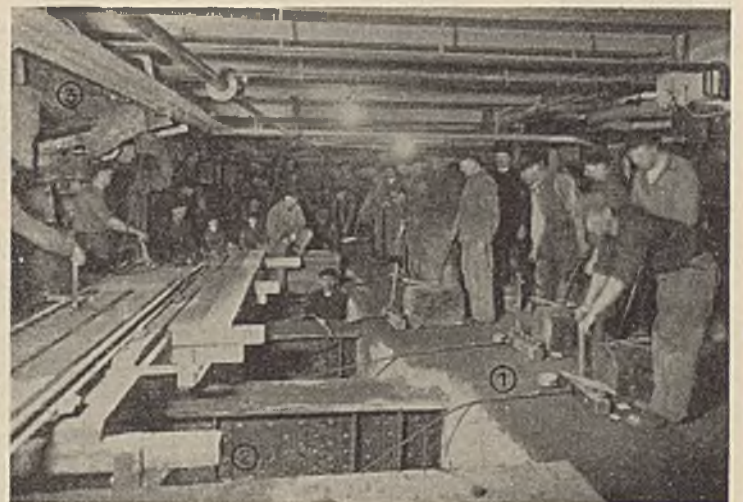
Abb. 23. Die Wasserdruckpressen am Haus Wertheim sind in Tätigkeit. Die gesamte Konstruktion wird einheitlich belastet. (1) Gegengewichtsplatte, (2) Kragträger, (3) Frontwand.
