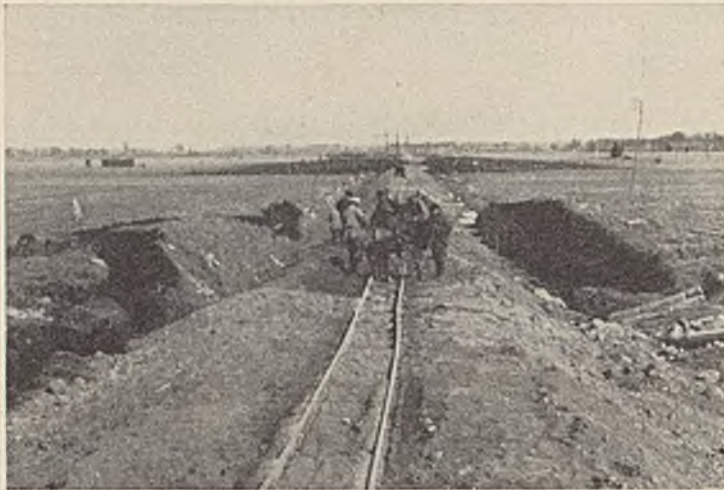
Abb. 3. Mit zunehmender Dammschüttung bricht das seitlich hochdrückende Moor unter mächtiger Spaltenbildung auf.
