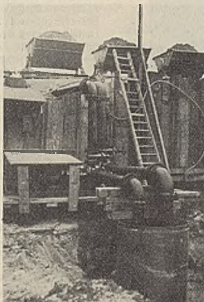
Abb. 10. Großbrunnen I in hoher Pumpenlage.
