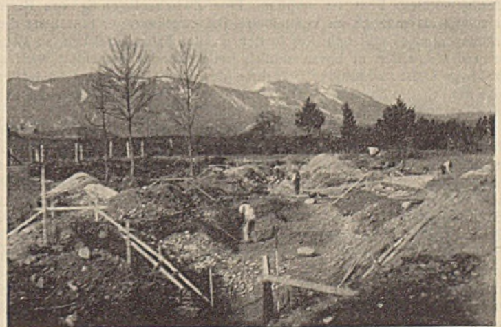
Abb. 51. Verbauung der Kaltwasserlaine bei Ohlstadt; Ansetzen des Sohlen- und Böschungspflasters in Bruchsteinen.
