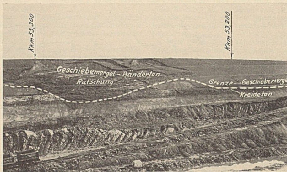
Abb. 5. Rutschung an der Südböschung im März 1932.
