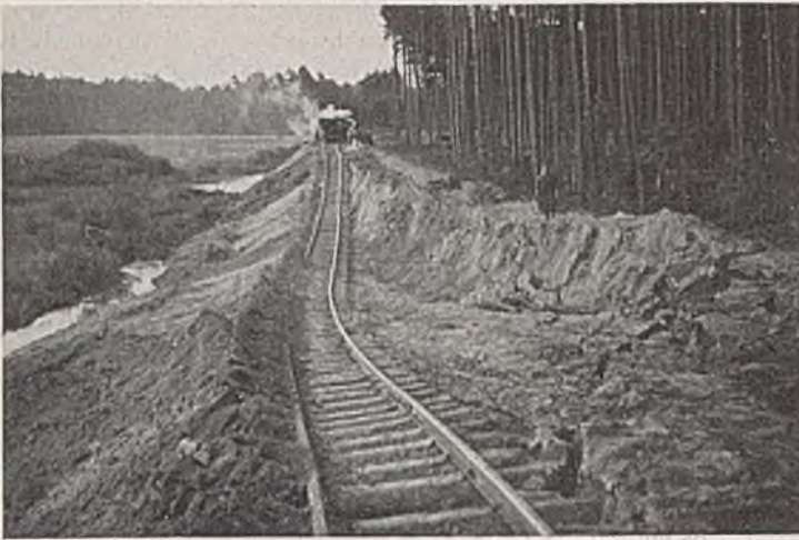
Abb. 6. Rutschung auf einer Kippe.
