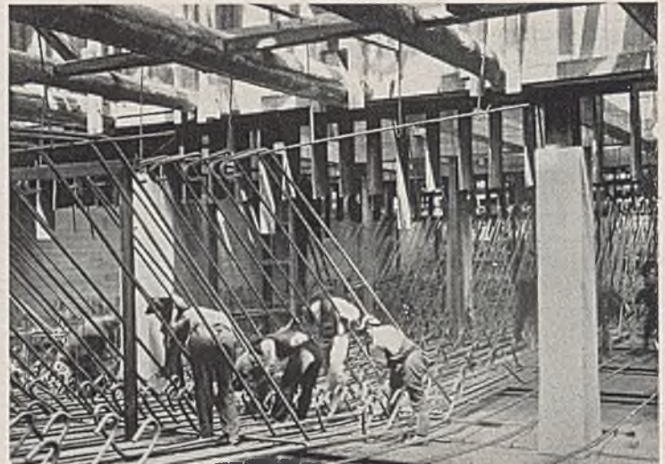
Abb. 29. Schleuse Stauwerder. Eiseneinlagen der Sohle.
