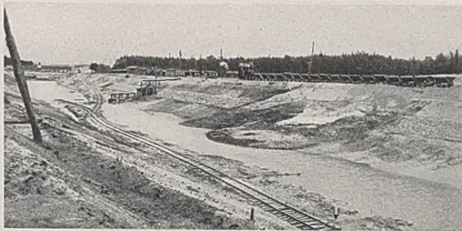
Abb. 22. Adolf-Hitler-Kanal. Rutschung bei km 5,00.
