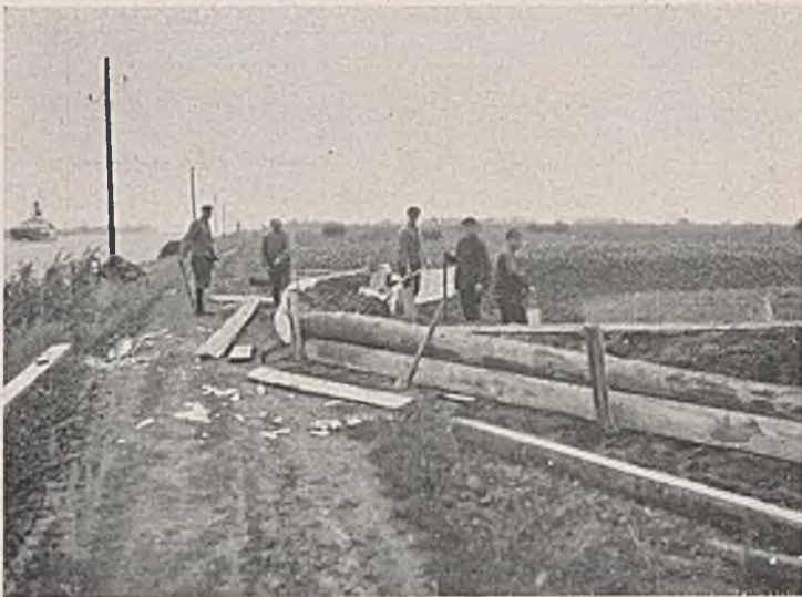
Abb. 14. Aufnahmebecken für den Schlickstrahl. Die Auftreffstellen sind mit Schwarten geschützt.
