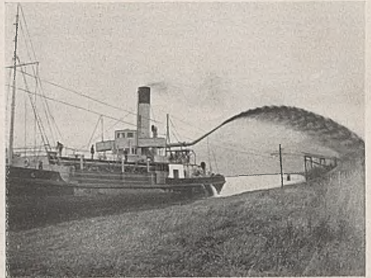
Abb. 17. Schlickbeförderung mit Spritzrohr auf hoch gelegene Ländereien mit Auffanggerüst, von der Seite gesehen.
