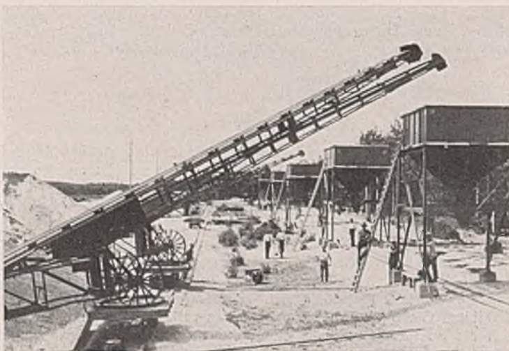
Abb. 7. Umschlag- und Siloanlage für Deckenlos 5/6.
