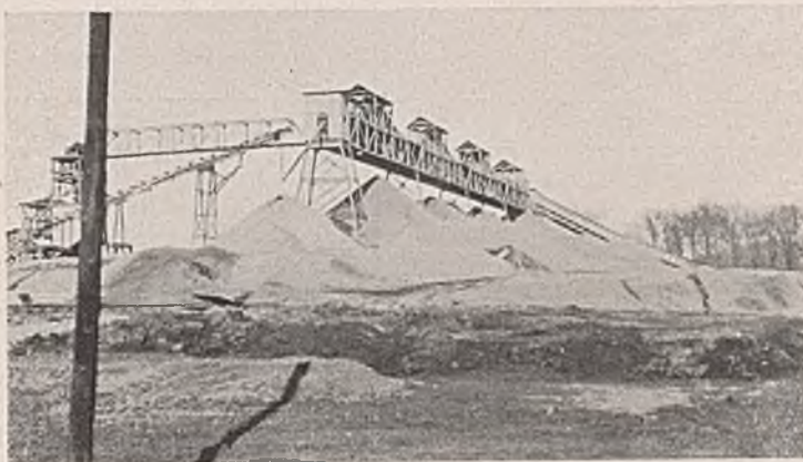
Abb. 26. Siebtürme und Halden für die Zuschlagstoffe.
