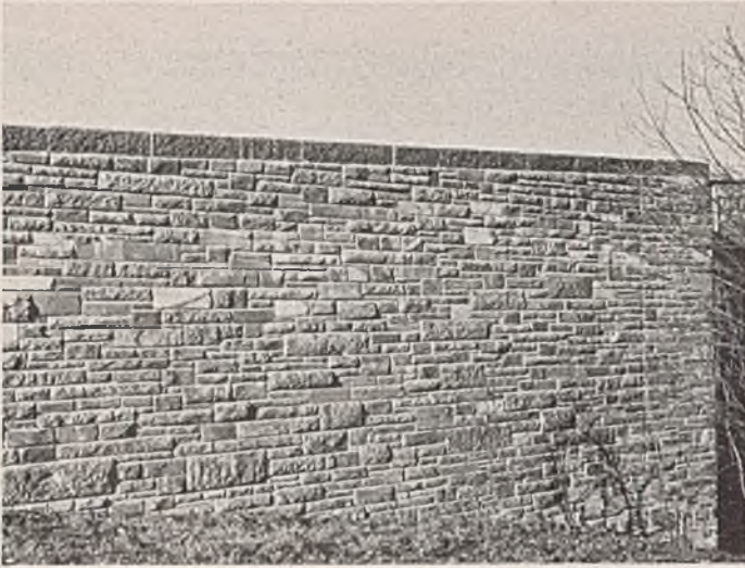
Abb. 12. Widerlagerflügel der Lützelbachtalbrücke. Unregelmäßiges Schichtenmauerwerk.
