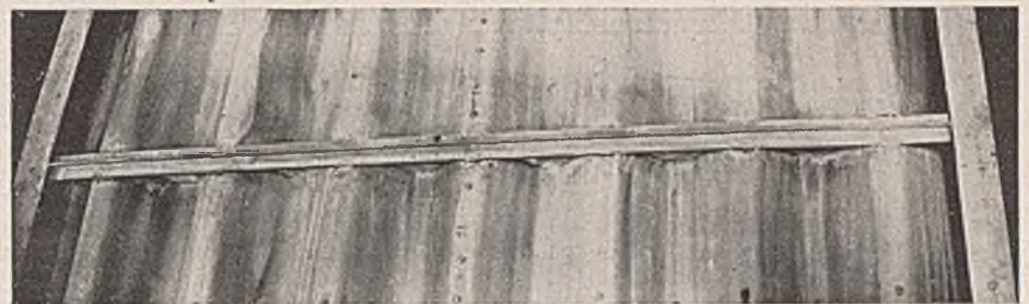
Abb. 32. Risse in der Schweißnaht an der Querschotte.
