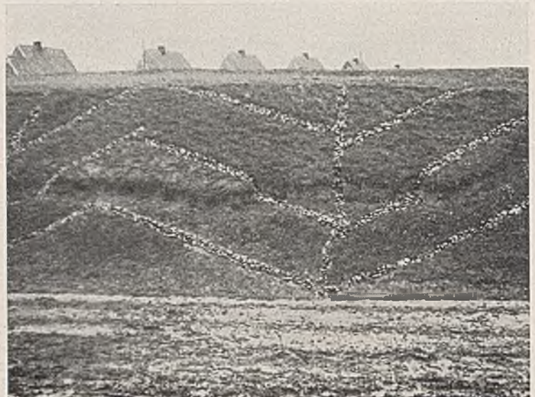
Abb. 12. Rutschung trotz Böschungsrigolen.
