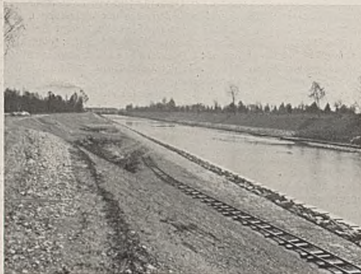
Abb. 7. Uferabbruch bei Iller-km 30. Fertiges Leitwerk.
