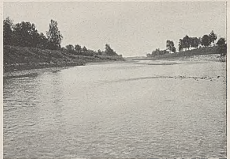
Abb. 6. Uferabbruch bei Iller-km 30. Flußaufwärts gesehen.
