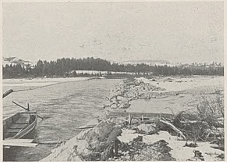
Abb. 9. Baudurchbruch bei Lech-km 159,6.
