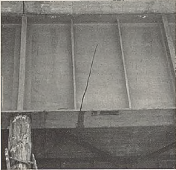
Abb. 8. Rißbildung bei der Autobahnbrücke Rüdersdorf.
