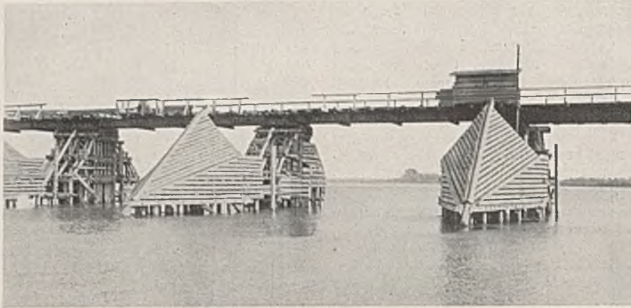
Abb. 6. Die im Eisgang 1917 vollständig vernichteten keilförmigen Eisbrecher der Eisenbahnbrücke unterhalb Sandomierz.
