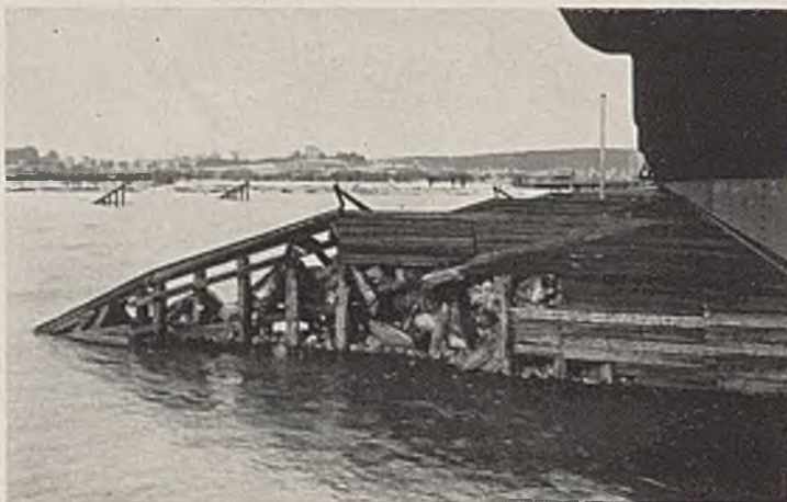
Abb. 8. Angebaute Eisbrecher der Straßenbrücke bei Pulawy. Erste Reihe der Eisbrecher vollständig zerstört.
