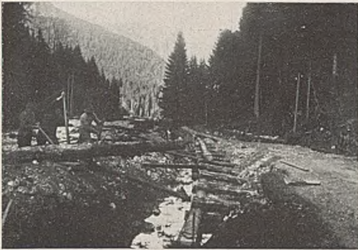
Abb. 23. Holzuferschutzbau im Elmaugries zur Sicherung einer Straße.
