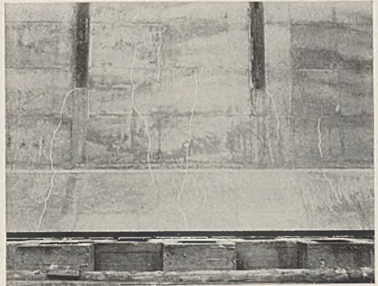
Abb. 11. Block mit Rissen.
