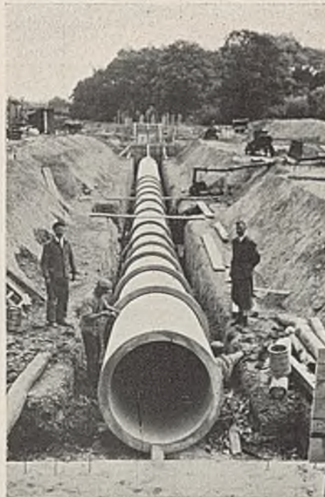
Abb. 69. Unterer Pröbsting-Düker aus Schleuderbetonrohren.
