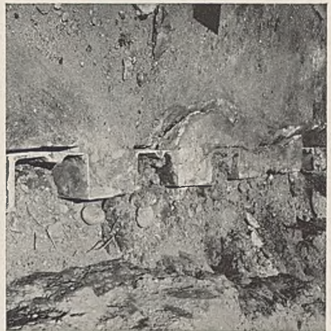
Abb. 4. Stufenbildung zwischen Pfeilerfundament und Spundwand (Flußseite).
