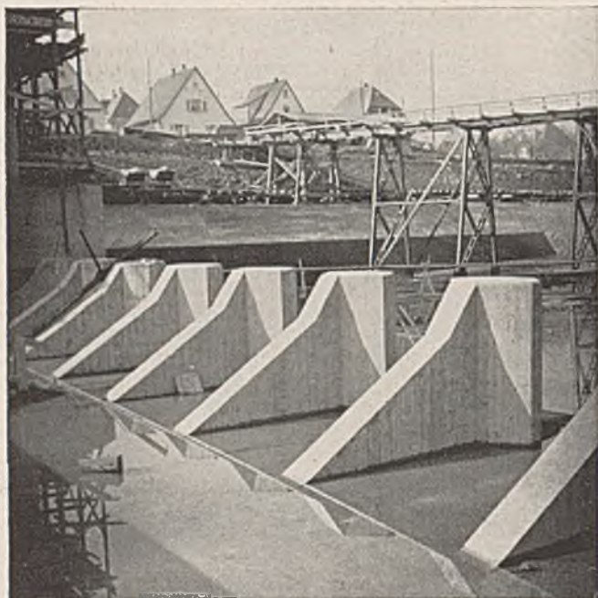
Abb. 14a. Energievernichter an einer Wehranlage.
