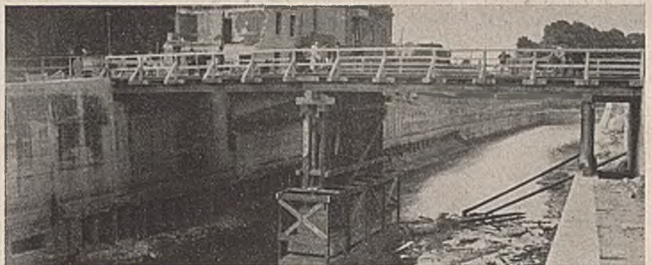
Abb. 9. Walzträgerüberbau in der alten Brückenachse. Doppeljoch auf betonierten Grundkörpern, zu deren Herstellung das Wasser des Kanals abgelassen wurde.
