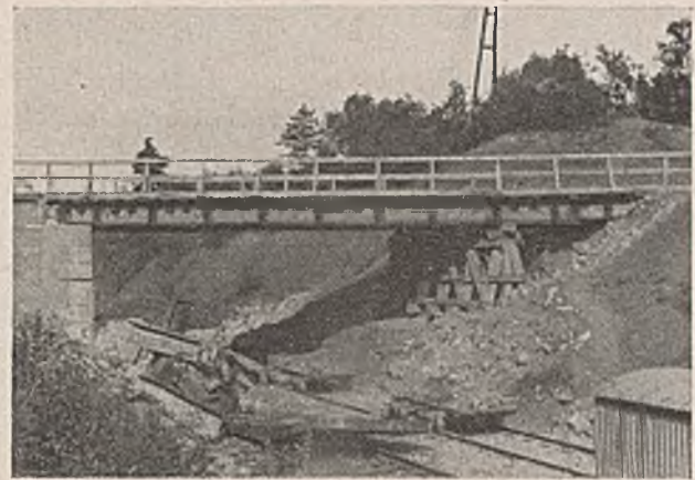
Abb. 12. Auflagerung des Walzträgerüberbaues am zerstörten Widerlager auf einem Holzbock.
