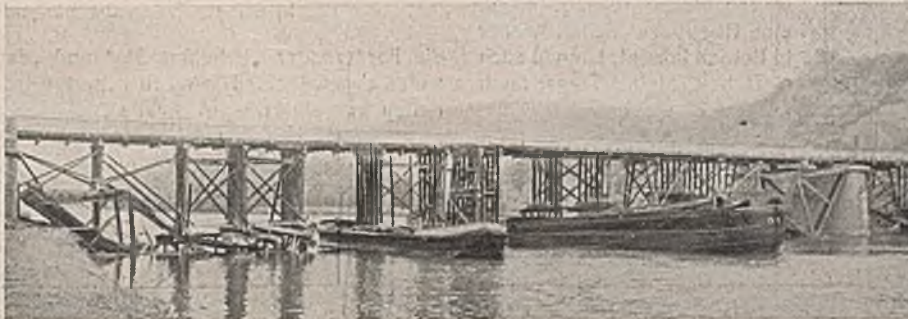
Abb. 2. Die zum Teil auf lose am Flußgrund aufgestellten Jochen, zum Teil auf Kähnen aufgeständerte schnelle Behelfsbrücke weist bereits starke Knicke in der Fahrbahn auf.
