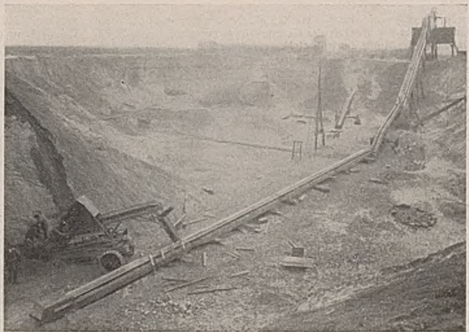
Abb. 16. Förderbandreihe aus versetzbaren Förderbändern (Bleichert).
