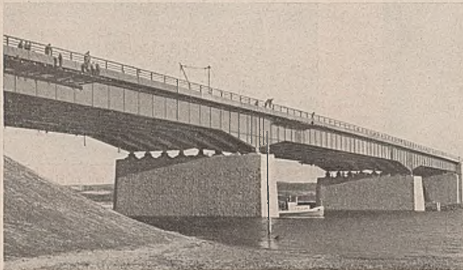
Abb. 7. Flußpfeiler mit freiliegenden Lagern.
