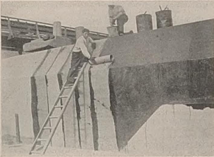
Abb. 13. Aufkleben eines Blechbandes in einem Stück als Dichtung der Rückwand der Endstrecke eines Autobahntunnels. Die Arbeit kann bei dem geringen Gewicht der Leichtmetallrolle von einer Leiter aus durchgeführt werden.
