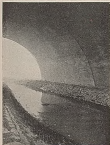
Abb. 32. Beim Einschütten gerissenes und mit Blechbändern gedichtetes Gewölbebauwerk. Die Dichtung blieb trotz des Auftretens sehr breiter Risse (etwa 15 mm) dicht.
