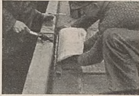
Abb. 11. Anschluß am Schrammbord einer Brückenfahrbahn. Einwalzen mit einem Rohr von kleinem Durchmesser. Die Masse quillt senkrecht hinter dem Blech hoch.
