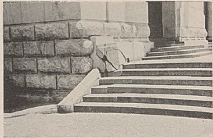
Abb. 8. Nationaltheater in Mexiko, an der Eingangstreppe sich bemerkbar machende Gebäudesenkungen.
