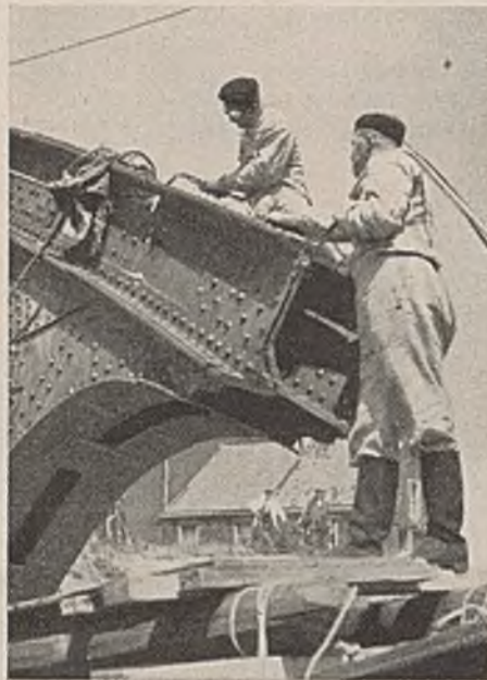
Abb. 3. TN.-Männer zerschneiden eine von den Engländern gesprengte Stahlbrücke.
