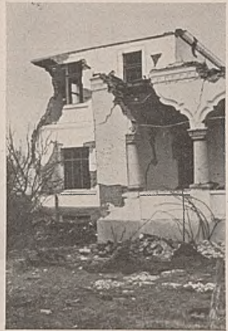
Abb. 3. Zerstörtes Haus bei Ploesti.
