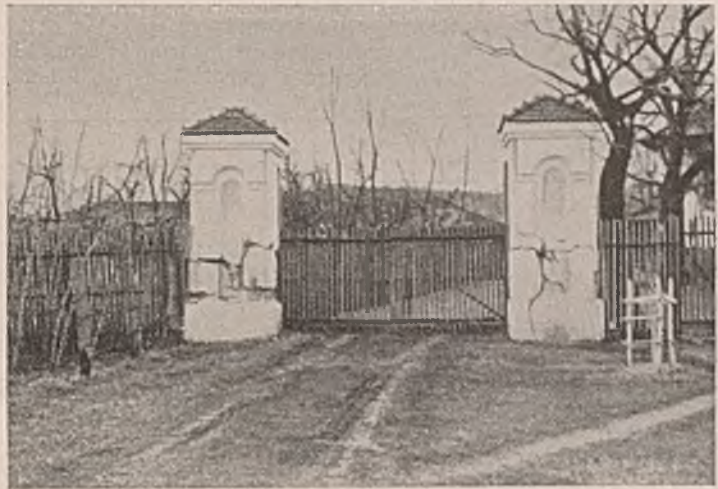
Abb. 10. Bruchstellen in frei stehenden Pfeilern.
