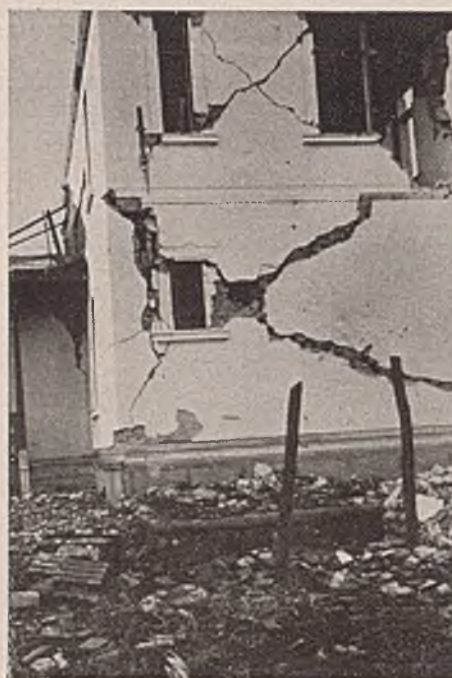
Abb. 7. Erhebliche Verblegungen des Ziegelmauerwerks ohne allzu große Risse.
